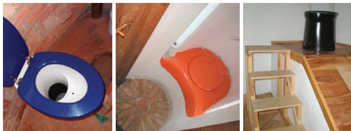
Stofftrenntoilette, Theater am Rand, Zollbrücke (D) Komposttoilette, Stenlille (DK) Fleming Abrahamsson Clivus Multrum, Oncins (E) Casa Torrozuala
