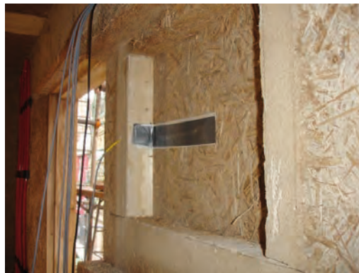
Bild 17: Temperaturfühler an der Grenzsicht 2, zwischen den beiden Dämmstoffplatten im Gefach, Foto IBP
