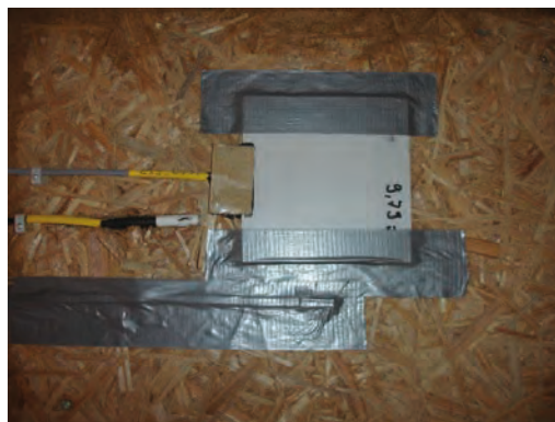
Bild 18: Temperaturfühler, Wärmefluss-scheibe sowie Feuchtefühler an der Grenzsicht 3, unterhalb der Innendämmung auf der zweiten Dämmplattenebene, Foto IBP
