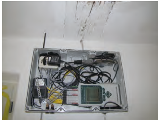
Bild 21: Ansicht des Gerätekastens mit eingebautem Datenlogger (links) sowie der Unterseite mit Kombisensor für das Raumluftklima und Messausgängen für die Holzfeuchtemessungen und den in den Innenputz eingelassenen Sensor für die Innenoberflächentemperatur, Foto IBP
